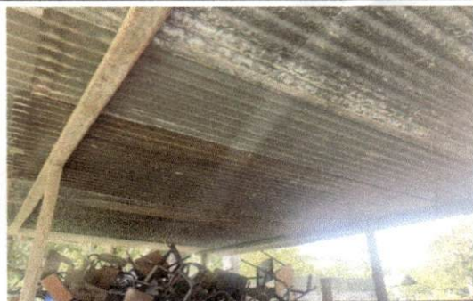
Foto 7: Lámina de la cocina corroida.
