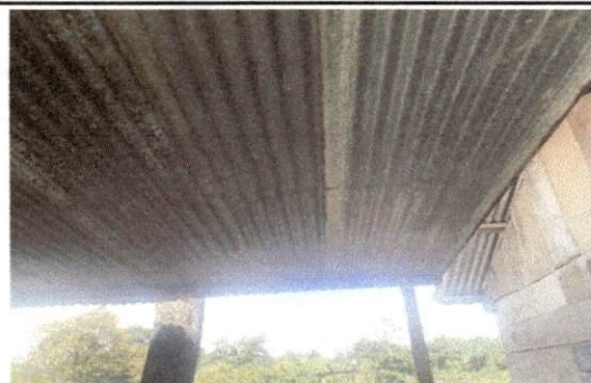
Foto 9: Lámina ondulada en malas condiciones.
