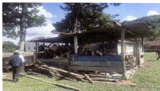
Foto 6: cocina sin muros ni estructura solida.
